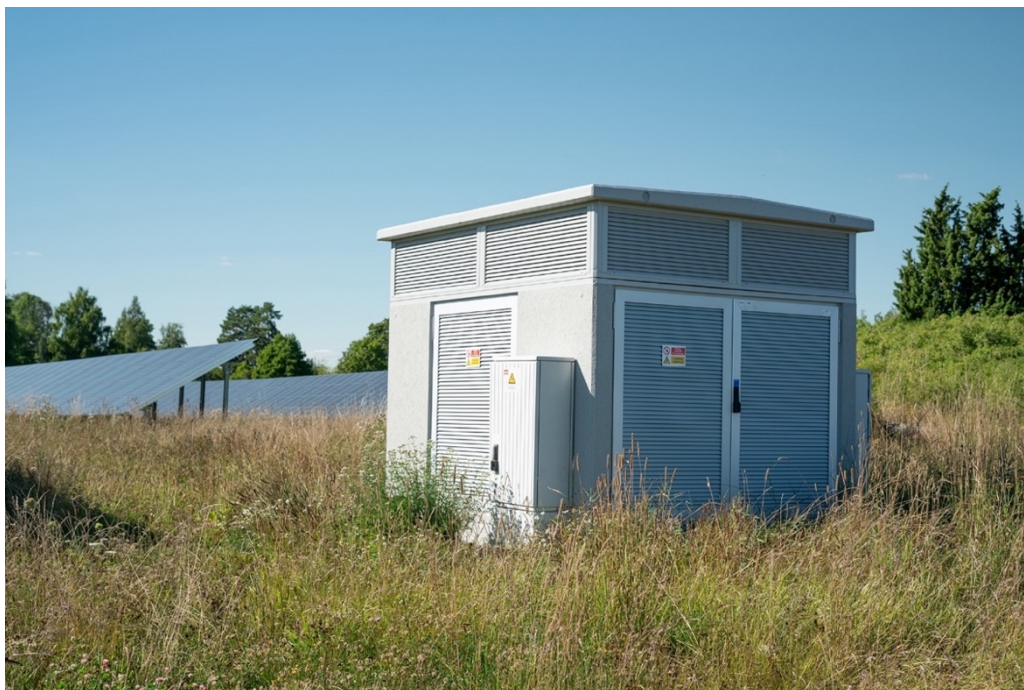
Figur 7 Exempelbild på en transformatorstation (EnergiEngagemang 2024).
